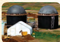
Digestor Anaeróbico Alberta, Canadá
